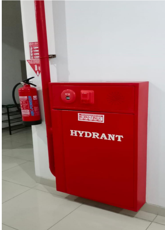
Pemadam Kebakaran Portable dan Hydran
